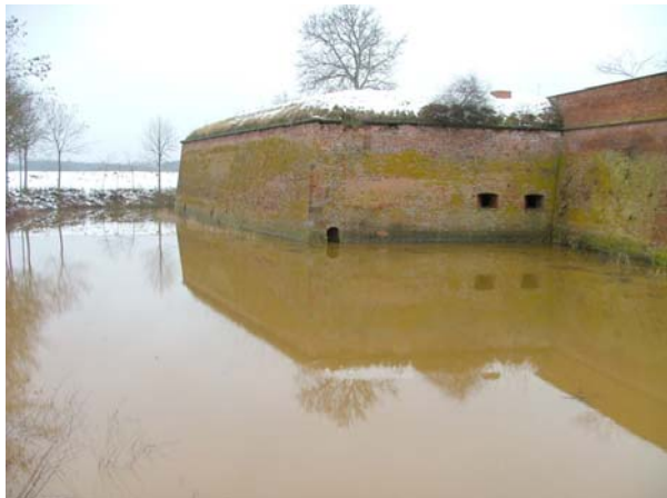
Abb. 24: Hochwasser überflutete im Winter 1994 den Außenbereich der Festung
