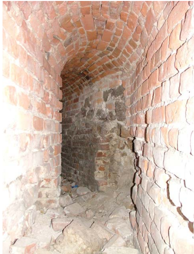
Abb. 23: Innenansicht des „Stasiganges“. Erkennbar sind rechts die teilweise eingestürzten Seitenwände
